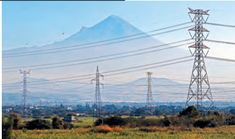
La red de transmisión eléctrica es una actividad exclusiva del Estado, por lo que su uso y mantenimiento dependen de cada administración. FOTO: CUARTOSCURO
